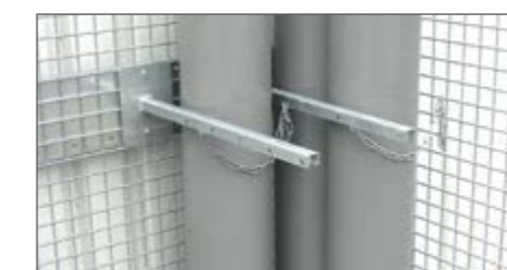
Dispositif de maintien des bouteilles de gaz, sécurisé par chaîne.
