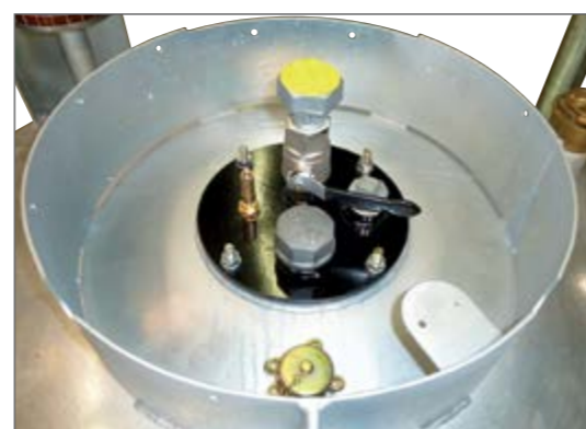
Vu du dessus, cuve sans pompe
