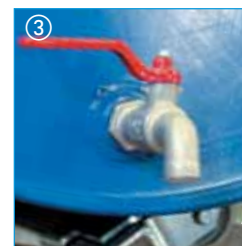
Robinet de soutirage
